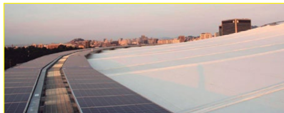
Sistemas fotovoltaicos instalados na cobertura do estádio do Maracanã pelo projeto Rio Capital da Energia, durante a Copa do Mundo
