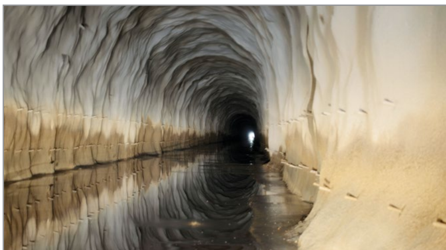
Túnel Cuncas II, com cerca de 4 mil metros, parte do Eixo Norte do Projeto de Integração do Rio São Francisco, em São José de Piranhas, Paraíba
